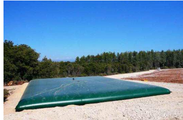
Figure 113 : Photographie d'une citerne
