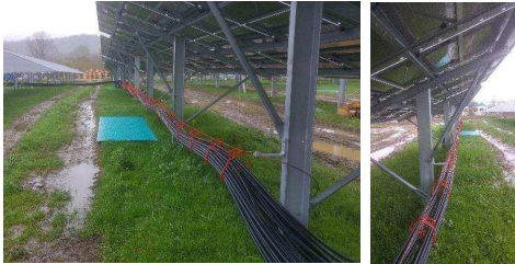
Figure 117 : Exemple de câbles aériens sous les modules
